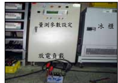
圖 4 放電負載設備
