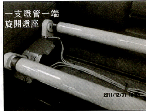
(b)狀況 2 燈管燈絲端損壞不能啟動
