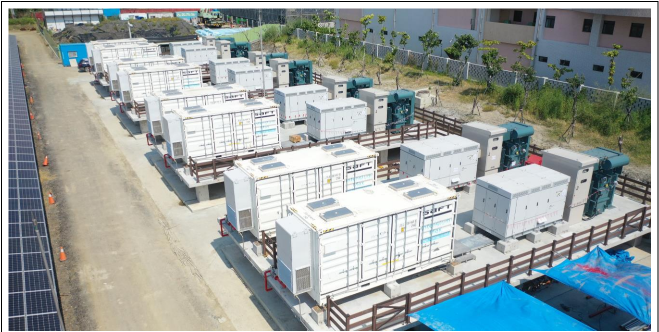
▲台電公司台南七股鹽田建置中之儲能案場
