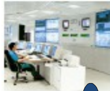
控制中心 SCADA
